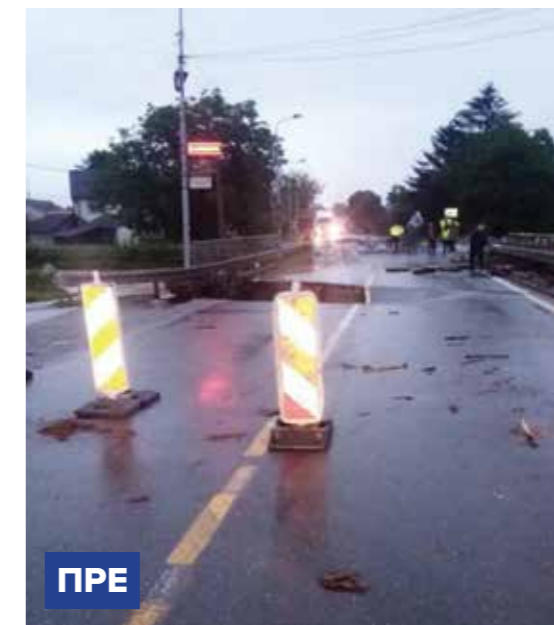
ИЗРАДА ДЕВИЈАЦИЈЕ НА МОСТУ ПРЕКО МУСИНЕ РЕКЕ, КРАЉЕВО
