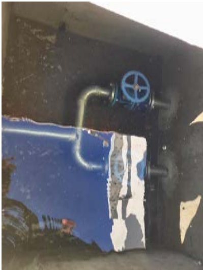
Слика 3. ППОВ Врање продор и накупљање воде
