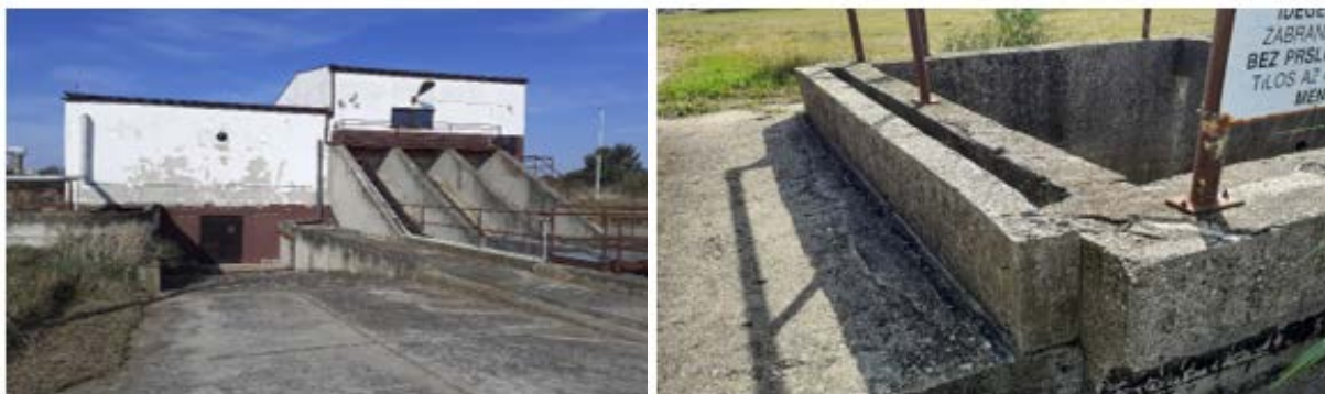
Слика 6. Објекат улазне црпне станице (лево) и изглед бетона објекат песколова (десно)
